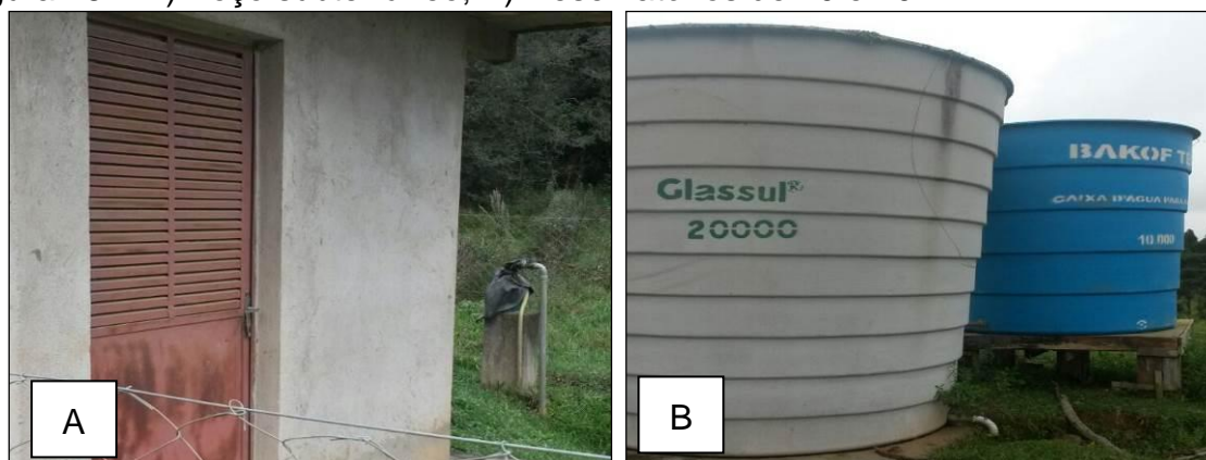
Figura 26 – A) Poço subterrâneo; B) Reservatórios de 20 e 10 m 3 .
