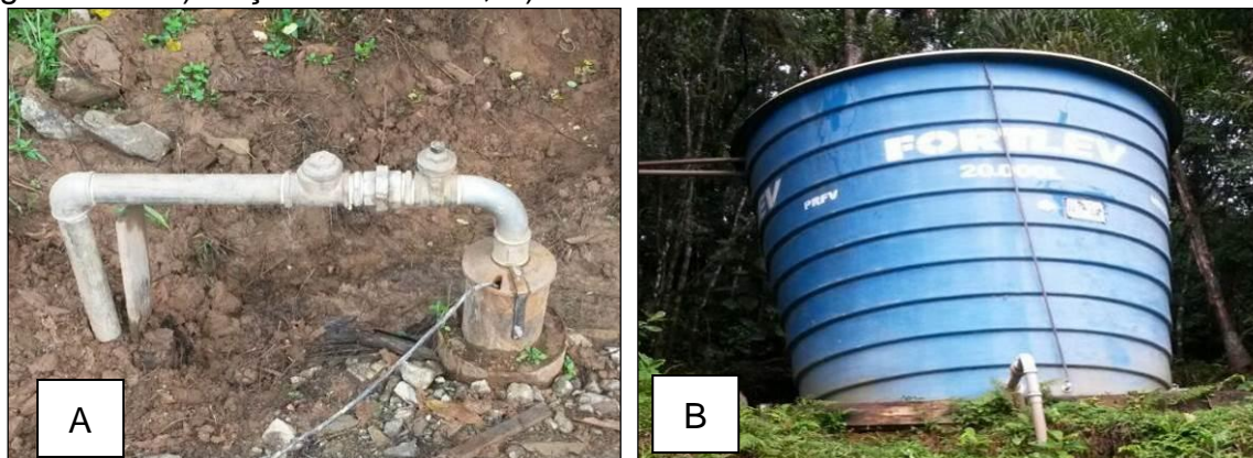
Figura 24 – A) Poço subterrâneo; B) Reservatório de 20 m 3 .
