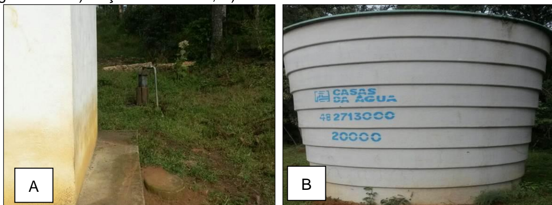
Figura 28 – A) Poço subterrâneo; B) Reservatórios de 20 m 3 .
